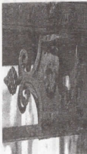
8-rasm. Korroziyaga uchragan panjara.
